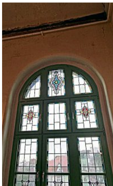
Wenn die Fördermittel reichen, dann soll der abgebröckelte Stuck über den neuen Fenstern in der Aula der Schule ergänzt werden.
