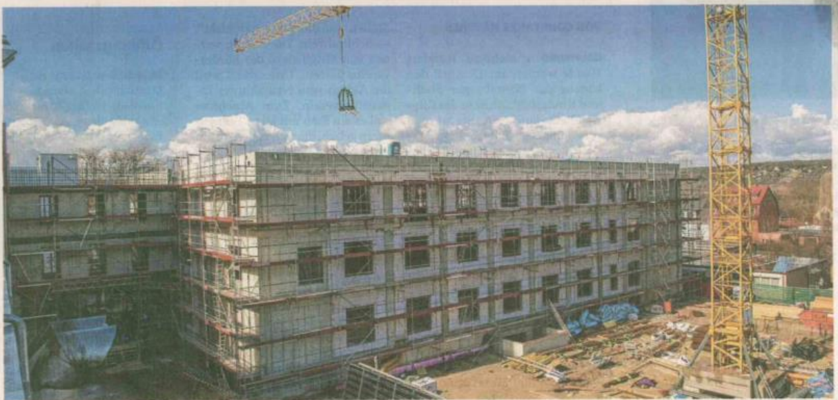
Das Saale-Unstrut-Klinikum Naumburg feiert Richtfest für Bettenhaus 7. In diesem kommen neue Facharztpraxen sowie einige Klinikstationen unter.
